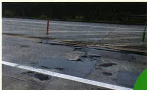
舗装路面の損傷状況
