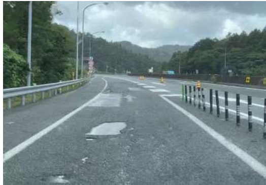
損傷した路面状況(越中境PA)
