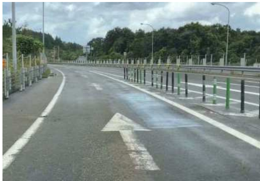
損傷した路面状況(名立谷浜IC)
